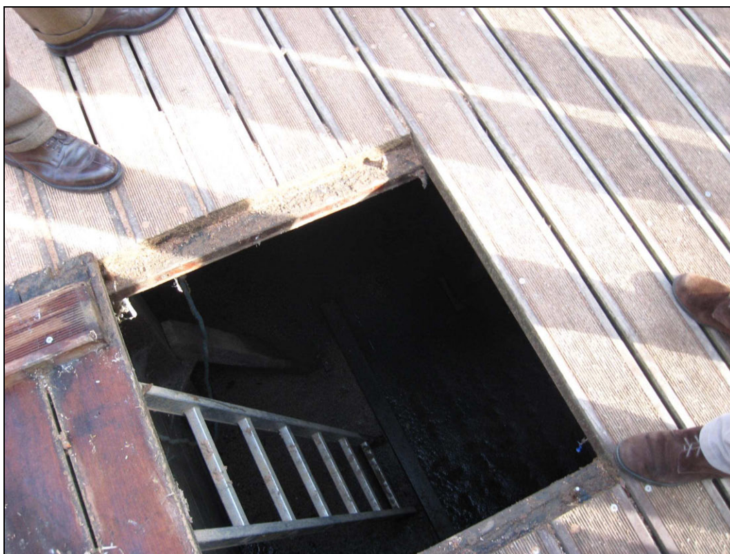
Photo n° 6 : bassin enterré sous un jardin public à Chatillon (92), accès au bassin – source photo : Prolog Ingénierie
