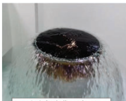
Arrivée de l'eau dans les réservoirs
